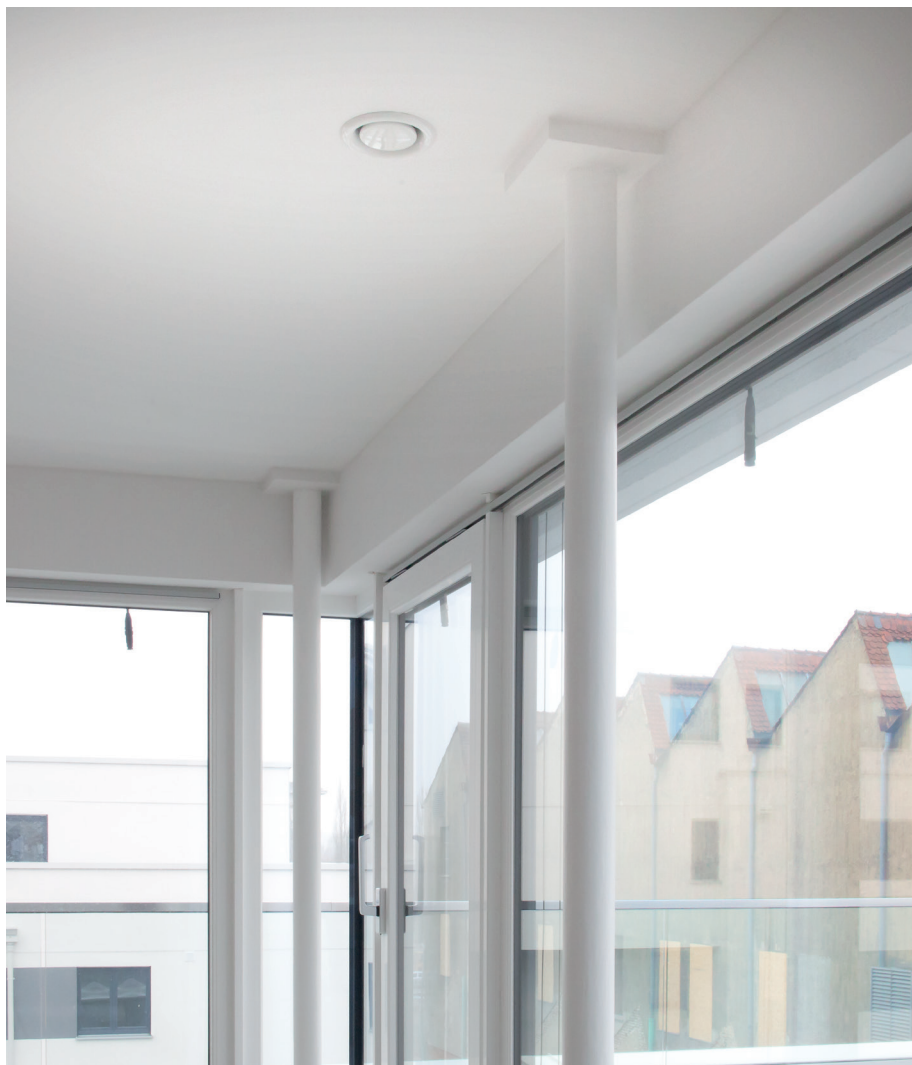
Das Bauunternehmen GS Wohnbau hat Lüftungssysteme mit Wärmerückgewinnung frühzeitig in der Bauplanung berücksichtigt. Die Luftverteilung wurde in die Deckenkonstruktion integriert, so dass auf Deckenabhängungen für Lüftungsleitungen verzichtet werden konnte. Bild: Vallox GmbH
