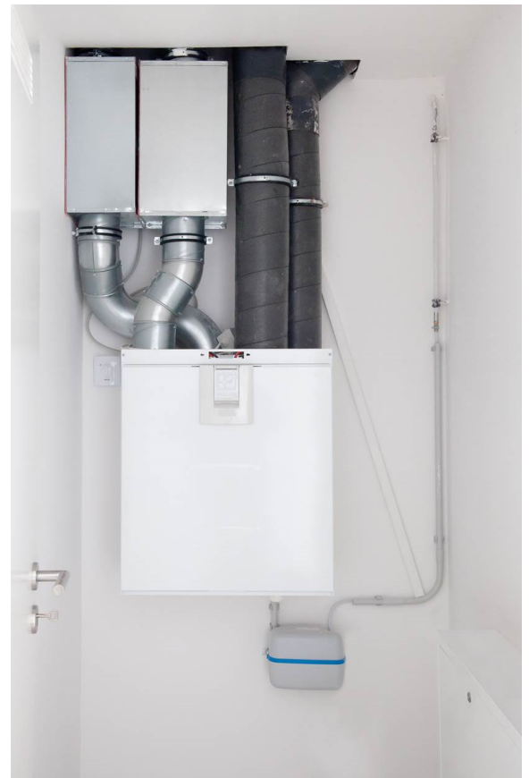
Die Komfortlüftungssysteme mit WRG finden durch die kompakten Abmessungen ihren Platz in Abstellräumen oder Wandnischen. Die Kondensatableitung wurde mit speziellen Kondensatpumpen gelöst, die das anfallende Kondensat zuverlässig und kaum hörbar in das Entwässerungssystem führen. Bild: Vallox GmbH
